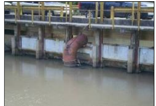
Sistemas de Bombeo Dañadas (Isla Cocuina).
